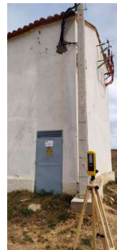
Foto 16. Medidor en trípode cerca del transformador de zona.
