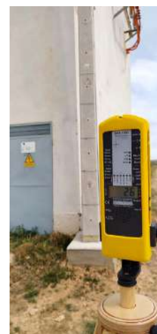
Foto 18. Medición de campo magnético alterno cerca del transformador.
