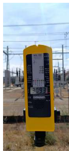
Foto 28. Medición de campo magnético alterno cerca de transformadores.
