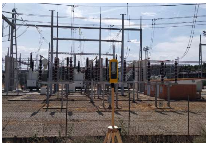
Foto 26. Medidor en trípode cerca de transformadores.
