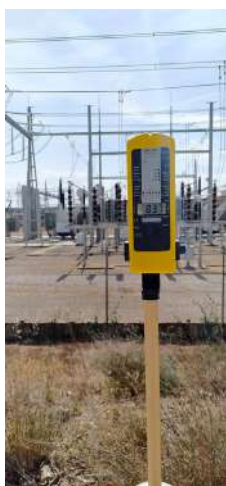
Foto 27. Medición de campo eléctrico alterno cerca de transformadores.
