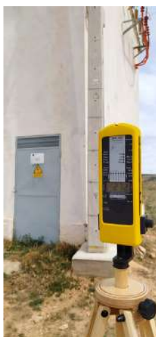
Foto 17. Medición de campo eléctrico alterno cerca del transformador.
